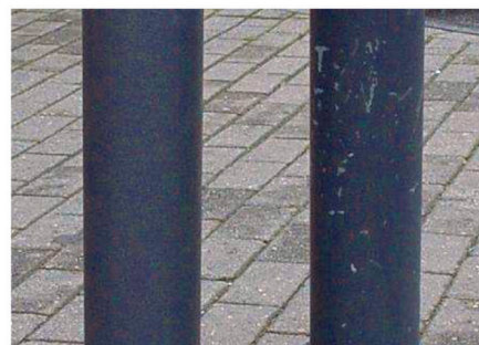
Porovnání: Pružný sloupek CITY & Železný sloupek.
